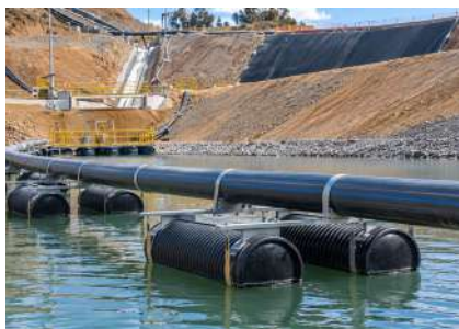
Sistemas de tuberías flotantes.
